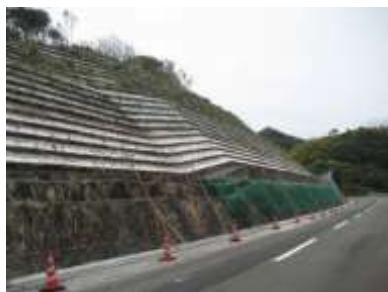
県道 27 号土砂崩れの爪痕
